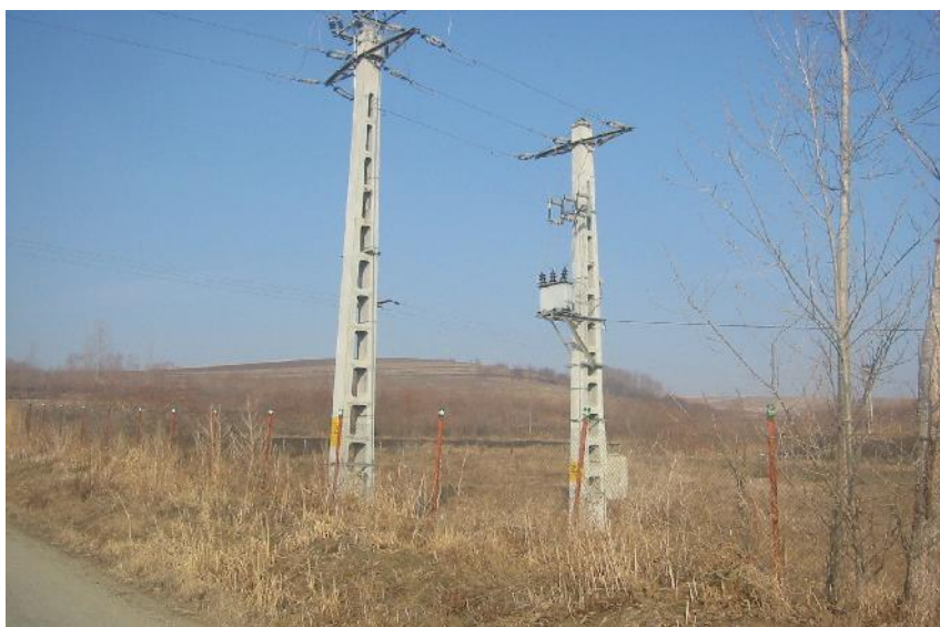
Vedere transformator si tabloul electric de alimentare
